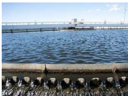
Estación Depuradora del Llobregat
